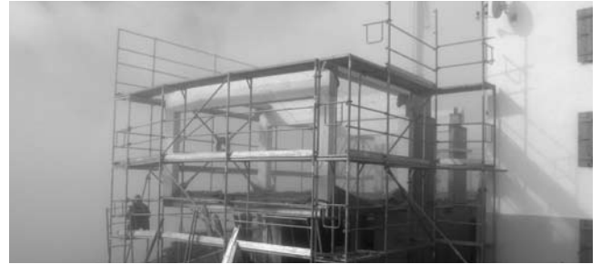
12.09.2011 – In weniger als einer Woche wurde der komplette Holzbau des Panoramasaals erstellt, dessen Auskrugung bereits sichtbar ist.
