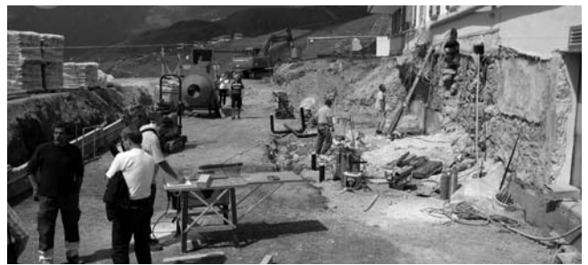
05.07.2011 – Der Altbau wird unterfangen. Felsblöcke werden weggespitzt und Sanitärleitungen unter der Betonbodenplatte verlegt.
